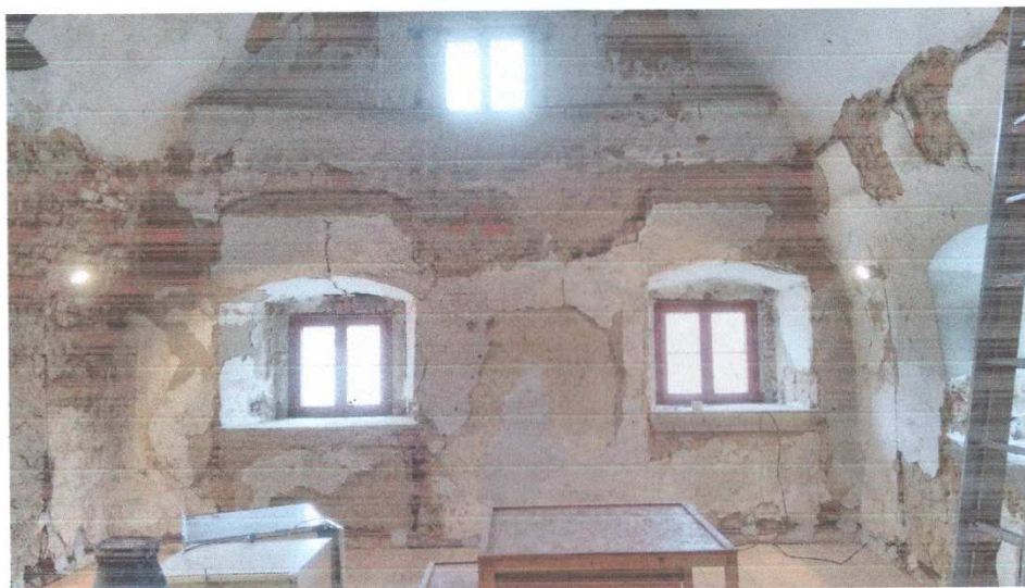
(Štítová stena po odstránení sekundárnych náteroch a nesúdržných plôch)
